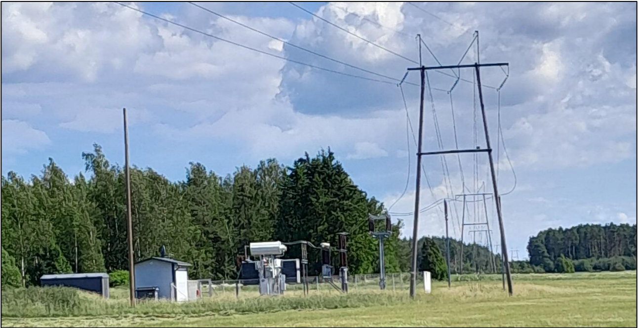
Kuva 11. Sähkönsiirtoasema Pyhän pohjavesialueella.
