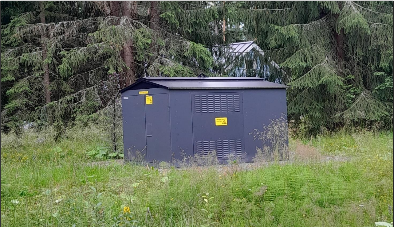
Kuva 6. Puistomuuntamo Vaikulan pohjavesialueella.
